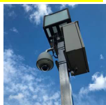
防犯カメラの設置
