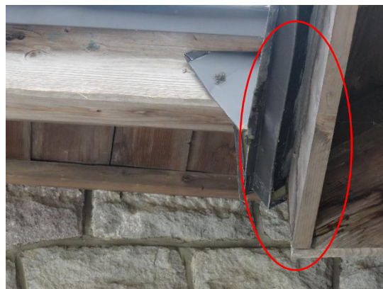
トタンの浮き
