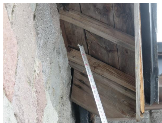
垂木、鼻隠しの折れ
