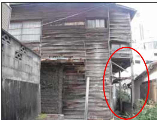
柱の数箇所に破損がある例
