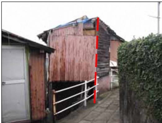
一部の柱が傾斜している例
