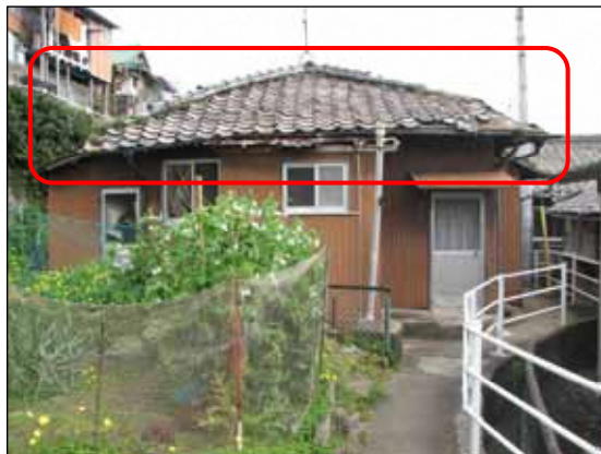
屋根に不陸がある例
