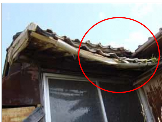
軒の裏板、たる木等が腐朽し、 軒が垂れ下がっている例
