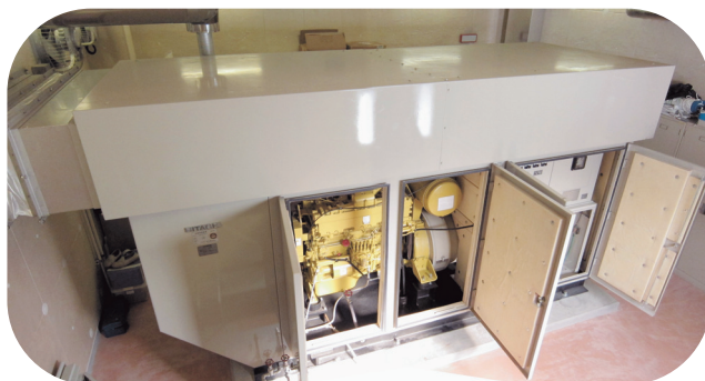
非常用発電機
